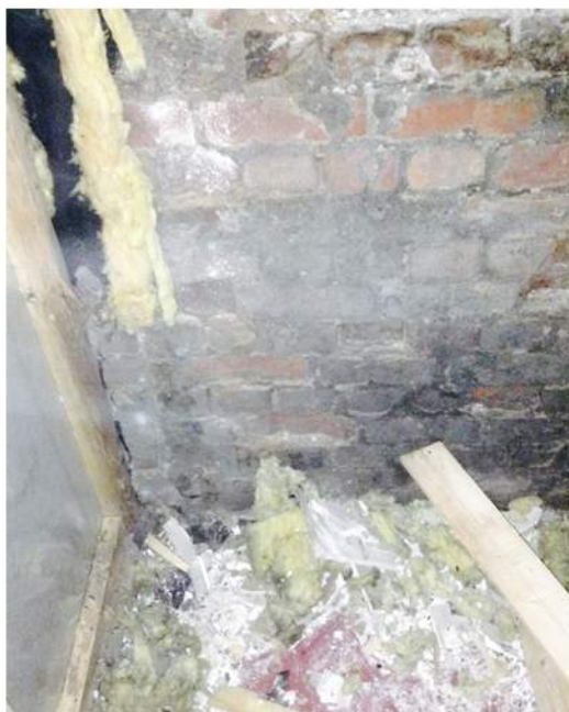
Misfarging, negativ biologisk aktivitet og saltutslag på yttervegg av teglstein.
