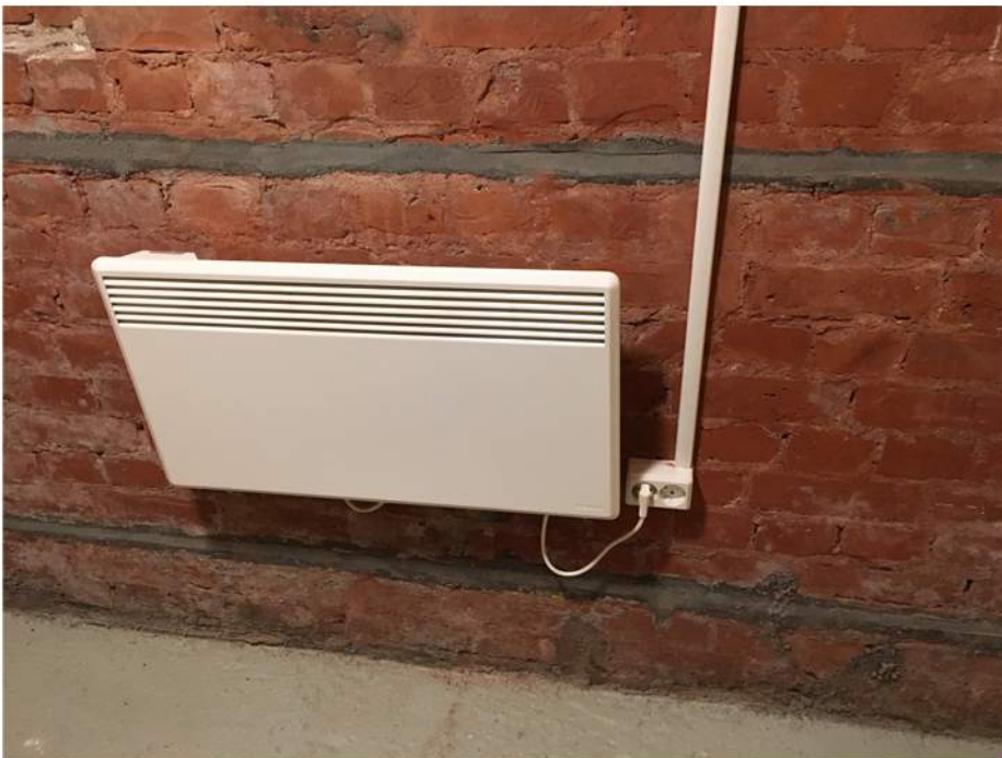
Fuktsikring fullført. De to gjenstøpte slissesporene viser hvor positive elektroder er installert inn i veggkonstruksjon.
