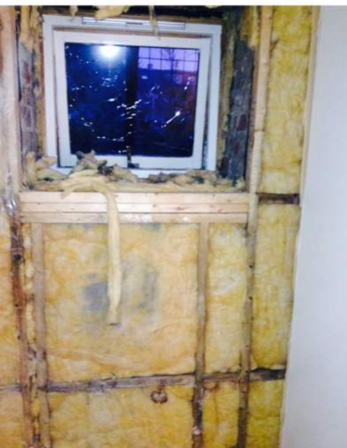
Utforing av yttervegg. Bindingsverk sterkt fukt- og råteskadet.
