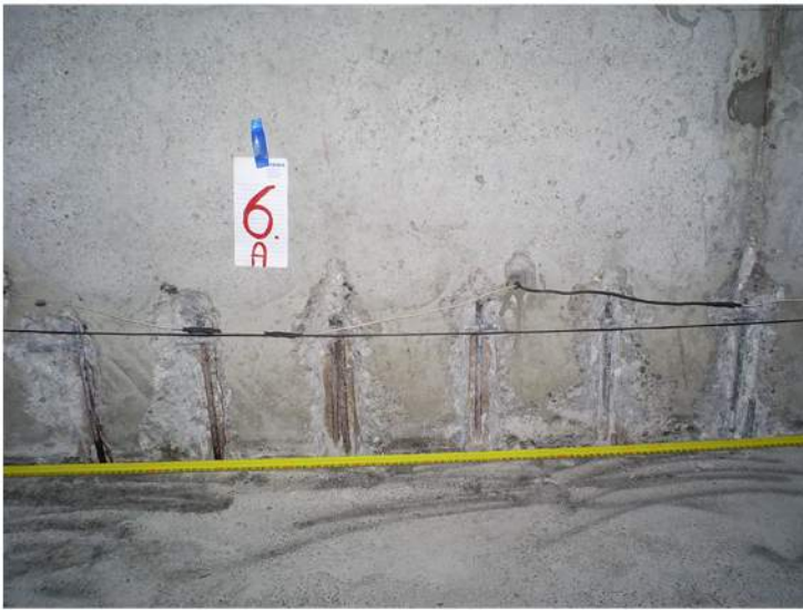
Viser installasjon av stikkelektrode av strømledende spesialkabel i pilar, samt lokalisering av skadd armering.
