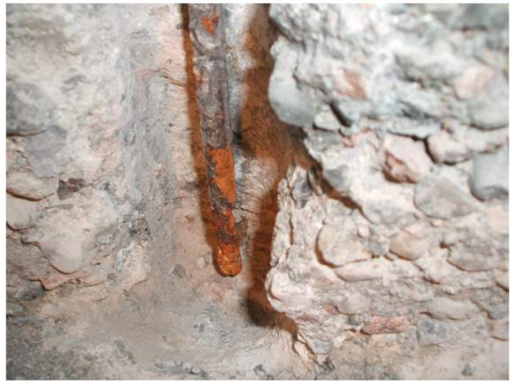
Korrosjonsødelagt armeringsjern i pilar. Erstattes med nytt jern og gjenstøpes.
