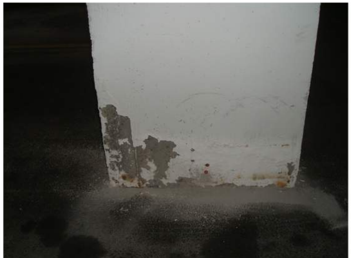
Tydelig fukttegn nederst på pilar - maling som løsner og misfarging fra korrodering av armeringsjern. Kapillært fuktoppsug fra grunn.
