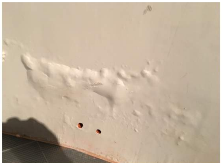
Maling som blærer nederst på yttervegg. Benyttet diffusjonstett maling.
