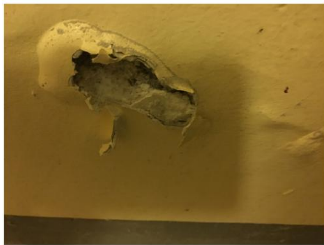
Maling som bobler og løsner. Oppsamling av saltutslag bak. Kommer av fuktavdamping ut i kjellerside fra fuktig konstruksjon.
