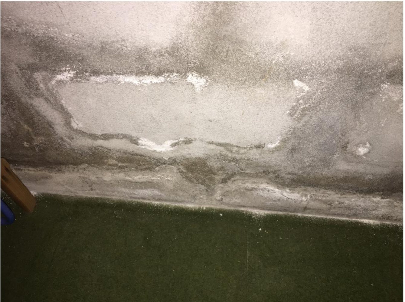
Saltutslag og misfarging på nedre del av Leca-konstruksjon. Bygg drenert, men drenering stopper ikke det kapillære fuktsoppsuget i vegg fra grunn og fundament.
