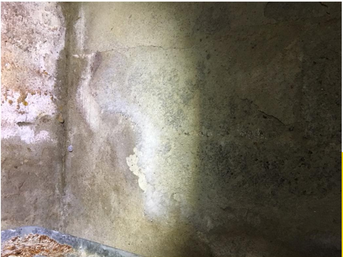
Saltutslag og misfarging på mur.
