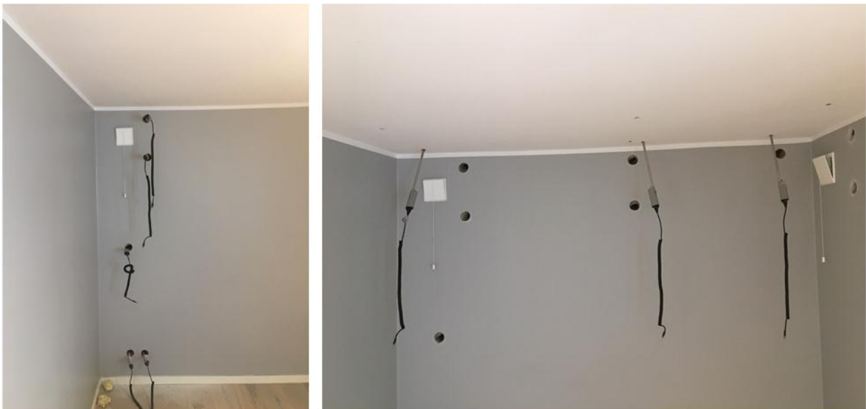
Metodisk fuktregistrering i vegger og tak. RF-målinger med fuktprober i ulike måledybde i konstruksjonene.
