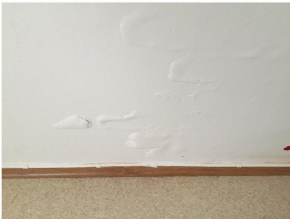
Malingsblærer på pusset teglstein. Kommer av fuktavdampning ut i romside fra våt konstruksjon.
