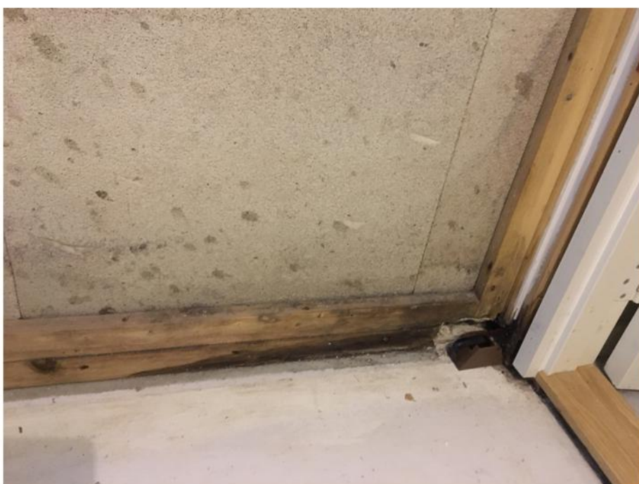
Råte- og fuktskader på bindingsverk, ved riving av kledning. Misfarging på mur.
