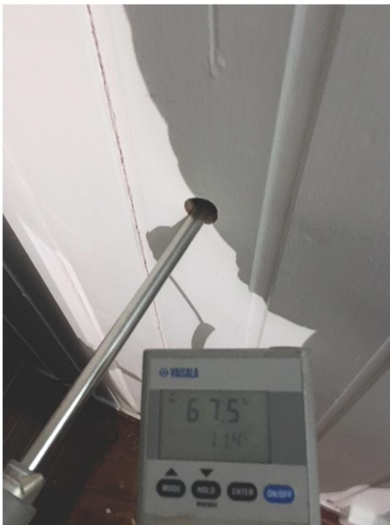
Kontrollmåling av fuktverdier i konstruksjon 6 mnd etter installasjon av kapillær fuktsikring. Målte 67,5% RF, noe som anses som "tørr"/akseptable fuktverdier.
